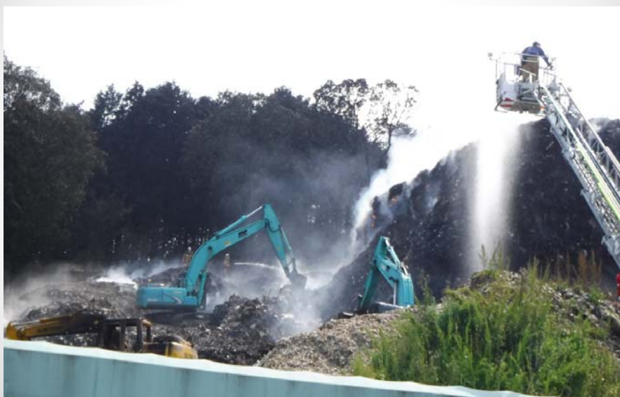
【南東側に重機2台進入し消火活動状況】 5月30日
